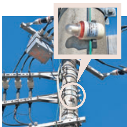
区分開閉器(PAS)の接地線で PASの絶縁破壊検知に!
